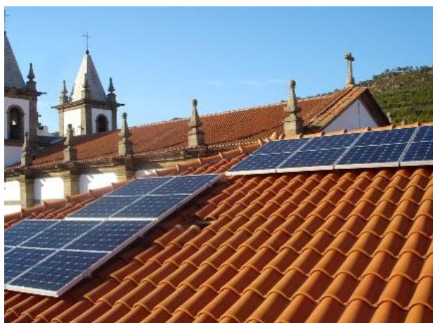
Figura 4.1 - Microprodução fotovoltaica num telhado de uma habitação [16]
