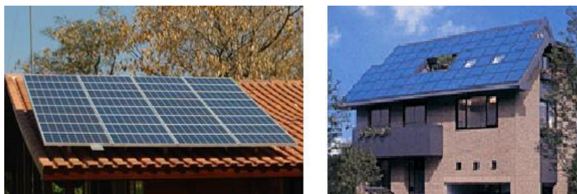
Figura 3.8 - Sistema montado no telhado inclinado (esquerda) e integrado no telhado inclinado (direita) [5]
